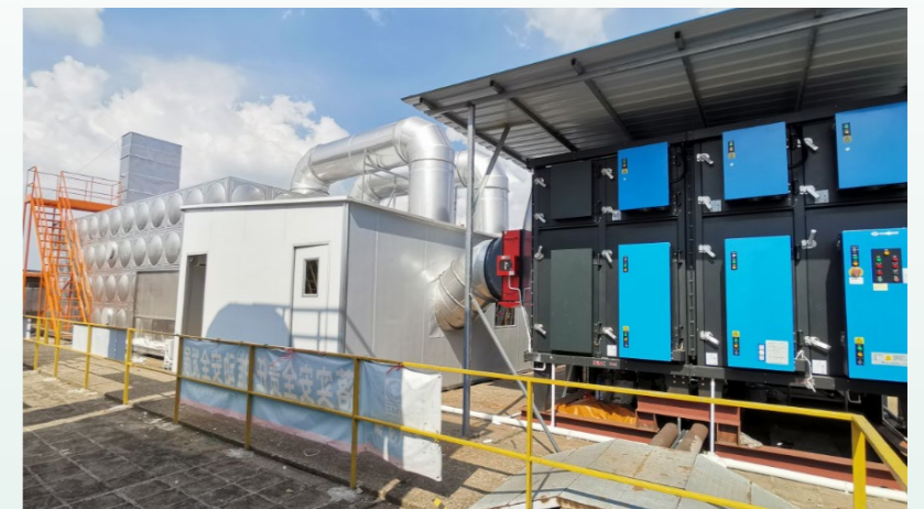
复合生物工艺废气治理设施
